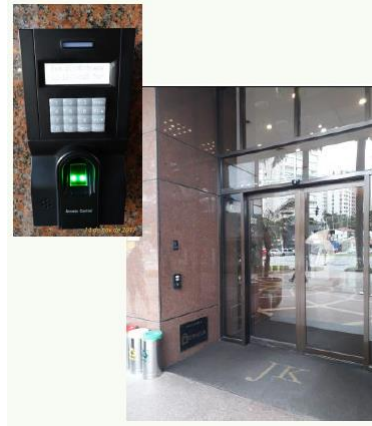
Implantação do Controle de Acesso Junto à Porta do Lobby
