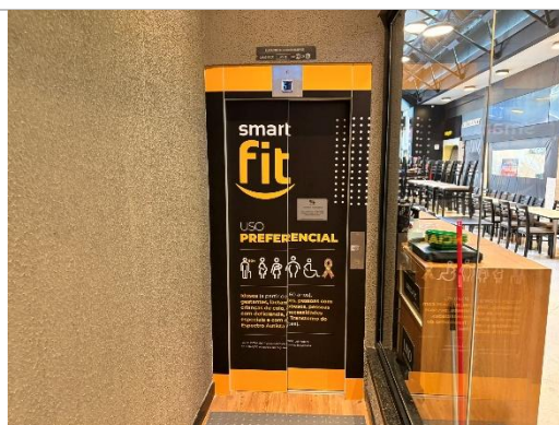
Elevador para acessibilidade
